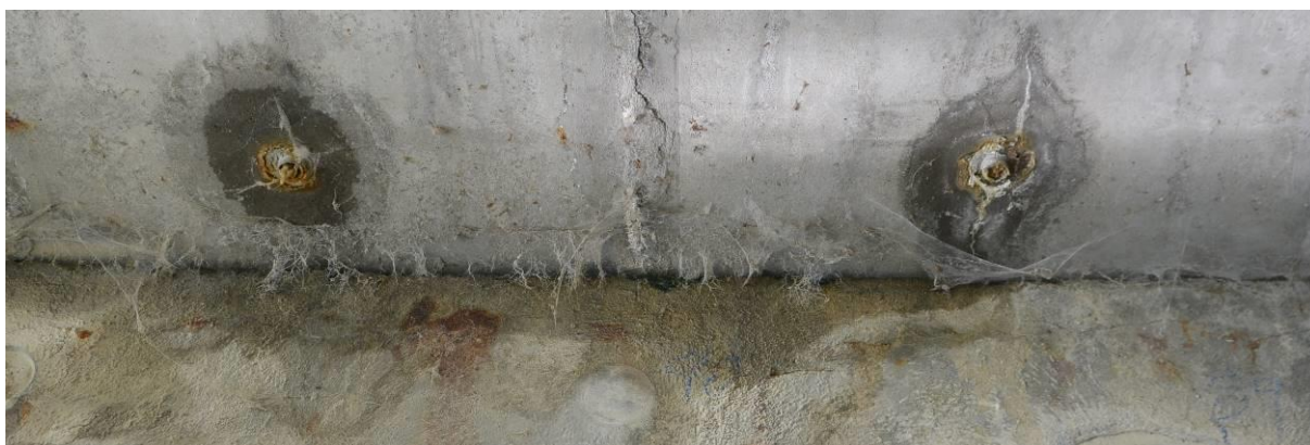
Obr.F45-127 Příklad odvodnění dutin nosníků, zde nosníků č. 12 a 11 při 1. podpěře, Jundrovské opěře. Pohled proti směru staničení a vzhůru,
