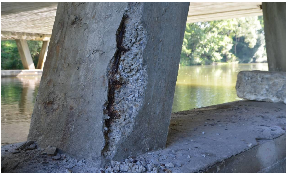
Obr.F45-143 Detail levé přední hrany pravého z 1. dvojice sloupů druhé podpěry. Pohled diagonálně ve směru staničení a po vodě, viz obr.F45-32. Stav po odstranění uvolněné části,
