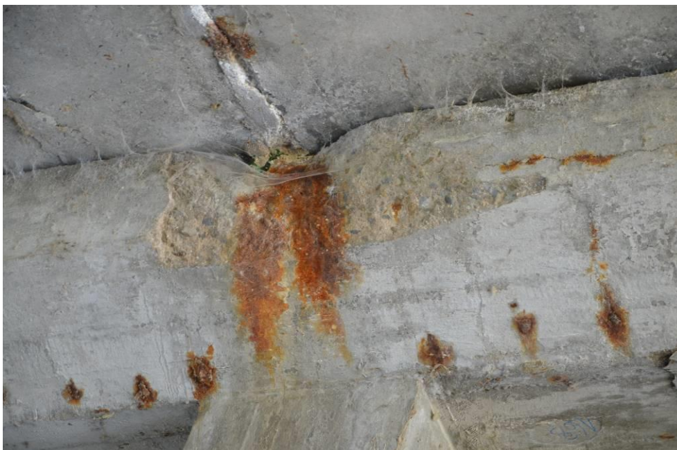
Obr.F45-151 Detail poruchy přední strany UP třetí podpěry nad 4. sloupem. Pohled ve směru staničení a vzhůru,
