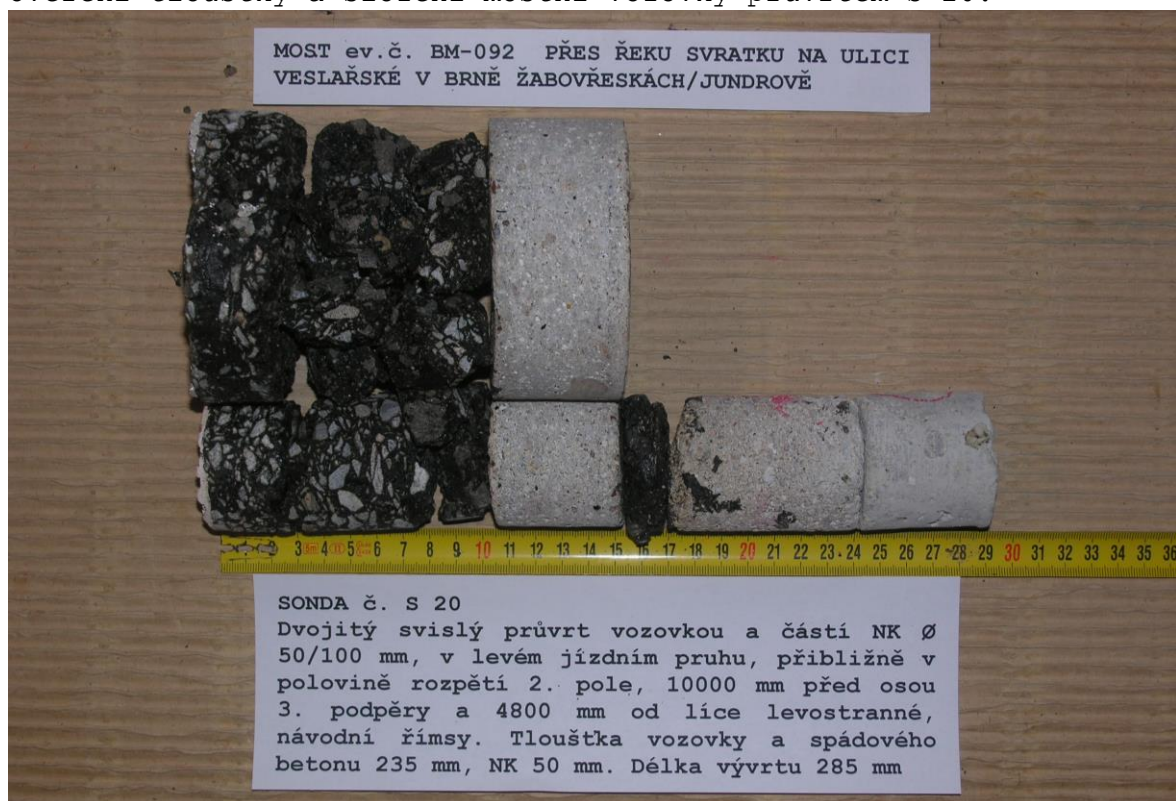
Obr.F45-401 Sonda č. S 20. Dvojitý svislý průvrt vozovkou a částí NK Ø 50/100 mm, v levém jízdním pruhu přibližně v polovině rozpětí 2. pole 10000 mm před osou 3. podpěry a 4800 mm od líce levostranné, návodní římsy. Délka vývrtu 285 mm.
