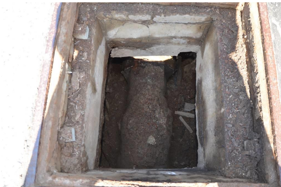
Obr.F45-201 Cizí zařízení, velmi pravděpodobně vodovod v dutině nosníku pod levostranným chodníkem v polovině rozpětí 2. pole. Pohled ve směru staničení a dolů,
