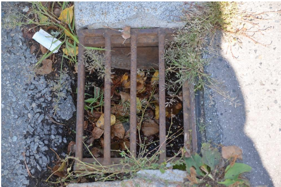
Obr.F45-199 Příklad mostního odvodňovače v pravostranném obrubníku. Pohled ve směru staničení a dolů,
