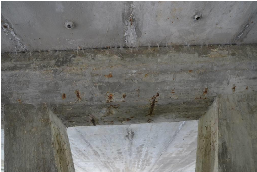
Obr.F45-29 Detail přední strany a podhledu UP druhé podpěry nad třetím až čtvrtým sloupem. Pohled ve směru staničení a vzhůru,
