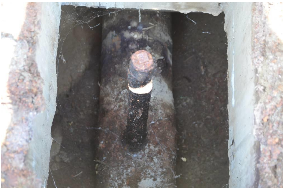
Obr.F45-200 Cizí zařízení, velmi pravděpodobně plyn v dutině nosníku pod pravostranným chodníkem v polovině rozpětí 2. pole. Pohled do revizní šachty ve směru staničení a dolů,
