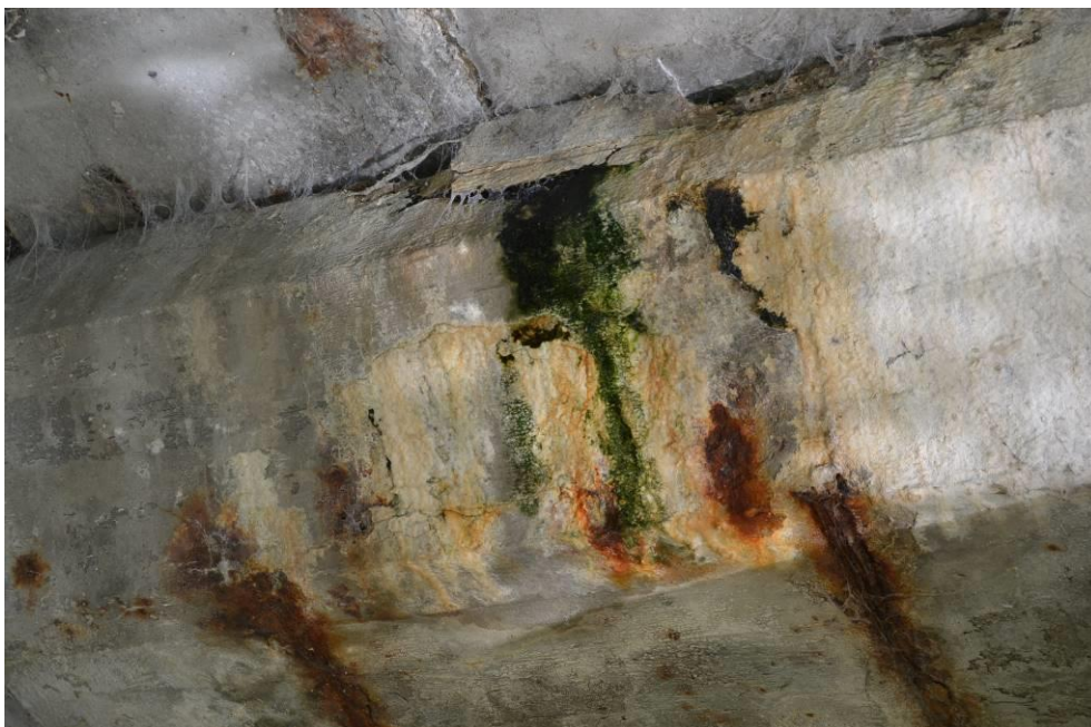
Obr.F45-153 Detail poruchy přední strany UP třetí podpěry pod 15. nosníkem. Pohled ve směru staničení a vzhůru,
