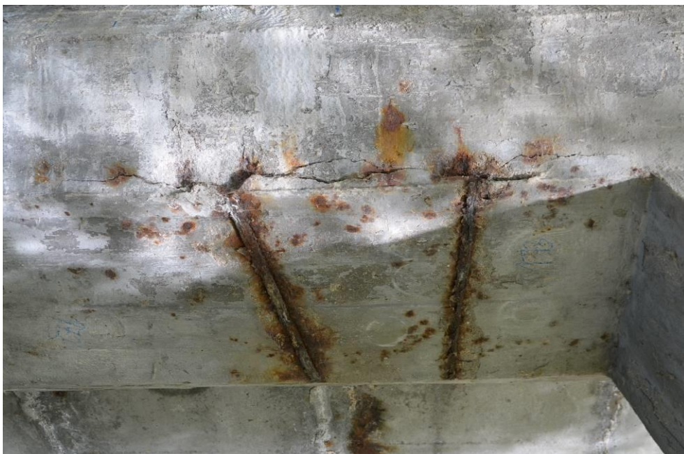
Obr.F45-154 Detail poruchy přední strany UP třetí podpěry. Pohled ve směru staničení a vzhůru,
